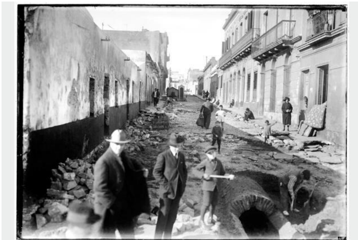
Zona de “El Bajo” durante las obras de construcción de la Rambla Sur. Década de 1920. (Foto: 18625FMH.CMDF.IMM.UY - Autor: S.d./IMM)
